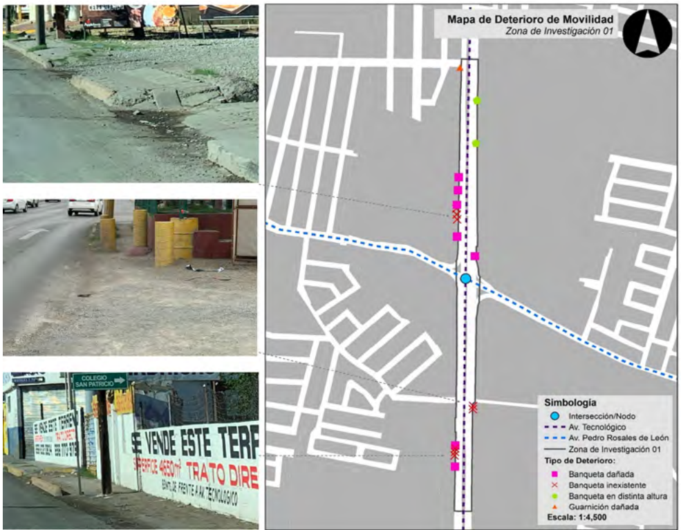
■ FIGURA 40. Mapeo de deterioro por banquetas dañadas o inexistentes, tramo 1
