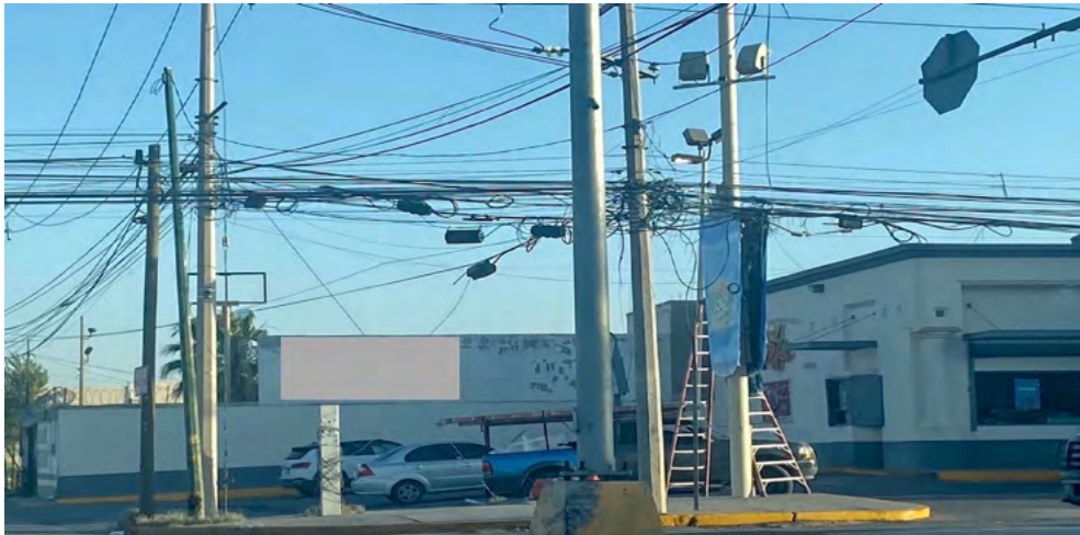
■ FIGURA 11. Cableado aéreo desordenado
